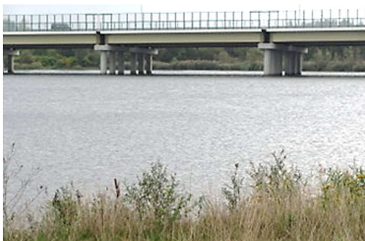
Rys. 10. Przerwy dylatacyjne w moście autostradowym źródłem hałasu
